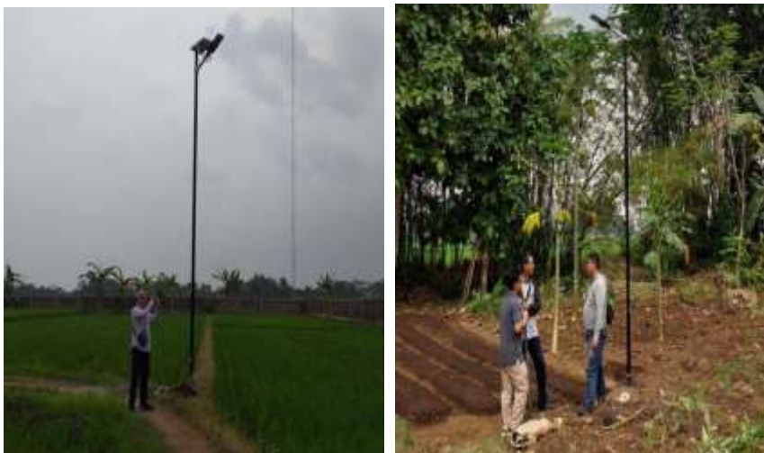
Gambar 9. Lampu PJU tenaga surya yang telah terpasang
