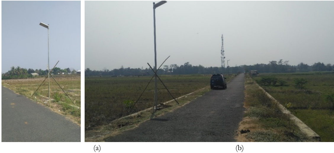
Gambar 4. Unit Lampu PJU Terpasang
